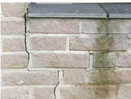
Exempel på fotografi av skada vid förbesiktning
